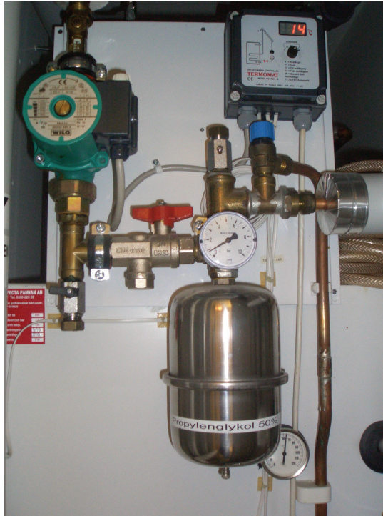
Figur 20. Varmtvannstank med tilhørende styringsautomatikk, måleutstyr og ekspansjonstank plassert i et skap på badet. Foto: Inger Andresen.
